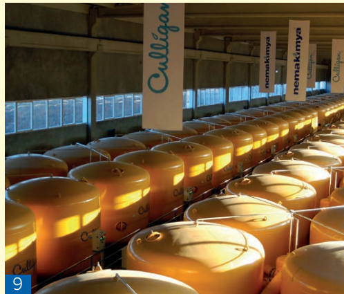
9 Planta de remoción arsénico para el sector municipal
