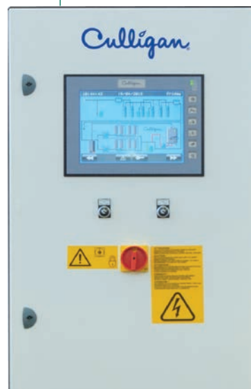
Cuadro eléctrico PLC
