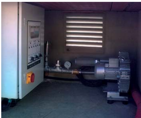
CUADRO ELÉCTRICO Y COMPRESOR
